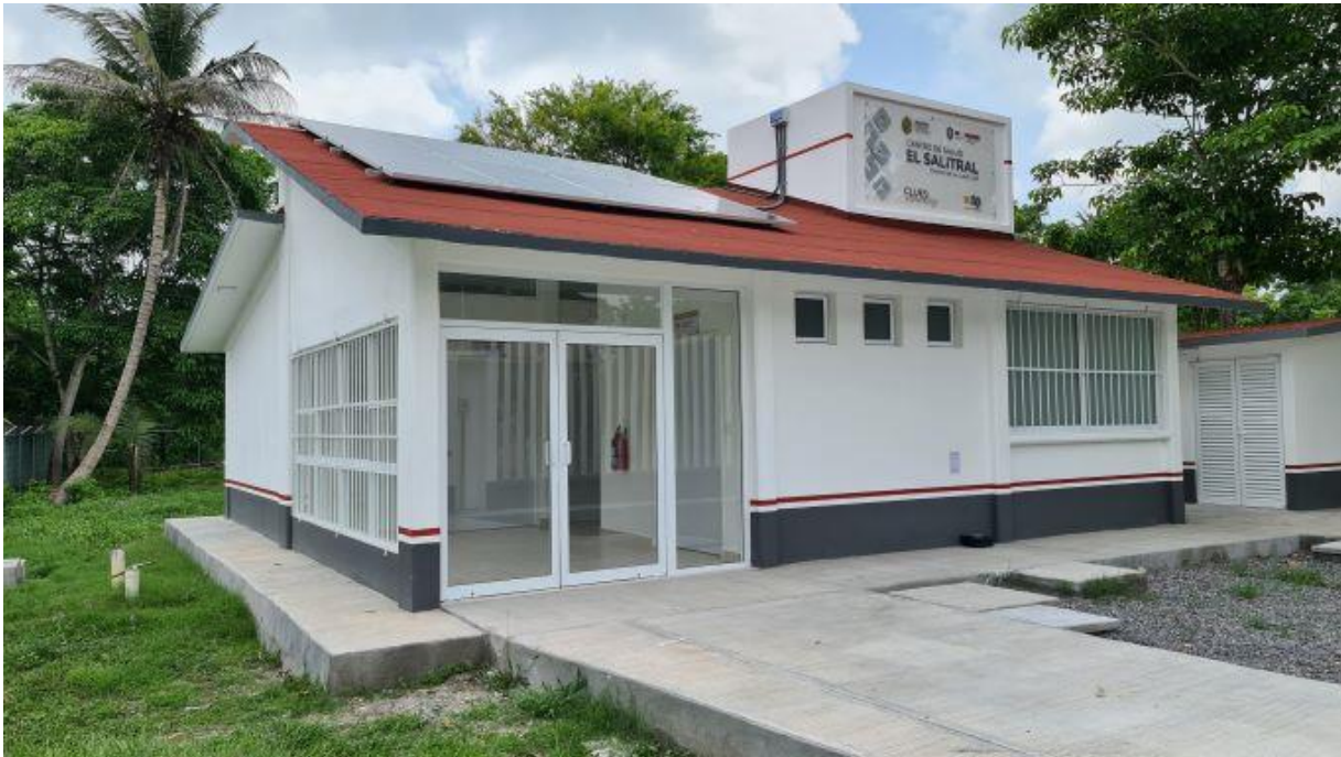
Mantenimiento de un centro de salud con paneles solares en la localidad El Saltral municipio de Ignacio de la Llave
